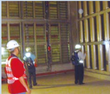
電務隊隧道通風工程消音器及風門
