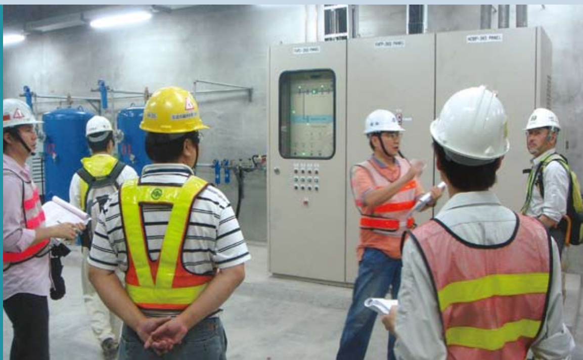
電務隊隧道通風工程配置盤檢測
