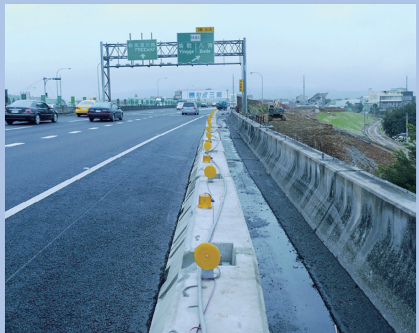
為降低對交通的干擾，採施工區域內外區隔的方式進行。（圖示為大浦交流道）
